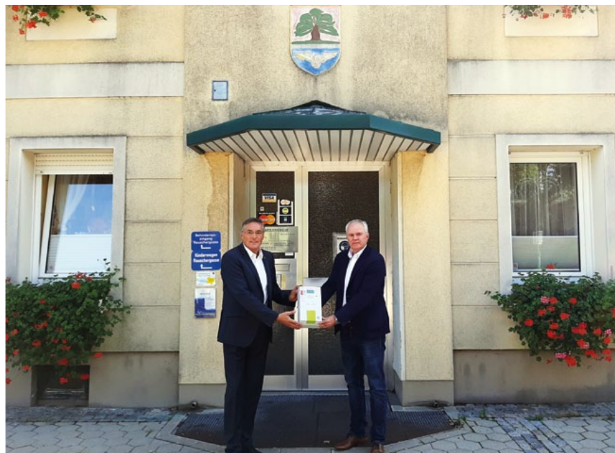
Ing. Gottfried Reisenauer, Leiter des Netz NÖ Service Centers Deutsch-Wagram zeigt Bürgermeister Ludwig Deltl den neuen Smart Meter.
